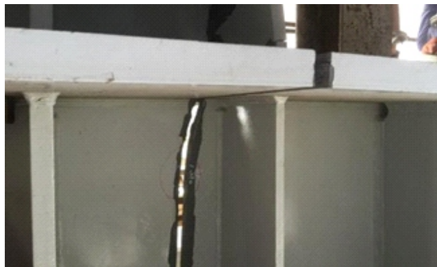
Hình 5. Nứt dầm thép cầu Vàm Cống
