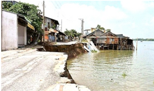
Hình 1. Sạt lở gây sập nhà ở xã Mỹ Hội Đông, Chợ Mới, An Giang
