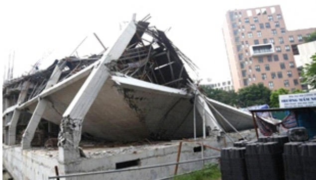
Hình 2. Sập đổ tầng 3 tại Trường Mầm Non Vườn Xanh, phường Mỹ Đình 1, quận Nam Từ Liêm, Hà Nội bị bục, khiến bê tông bị tràn xuống. Nguồn: http://tuoitre.vn , 26/09/2017
